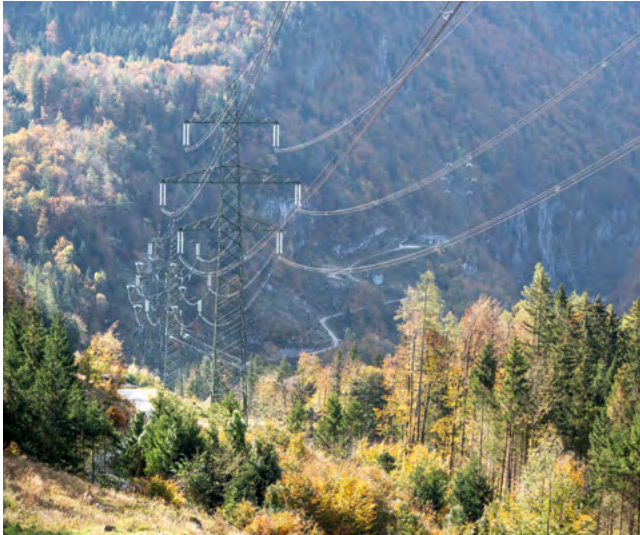
Die neue 380-kV-Salzburgleitung umfasst 449 Masten und eine Leitungslänge von 128 Kilometern.
